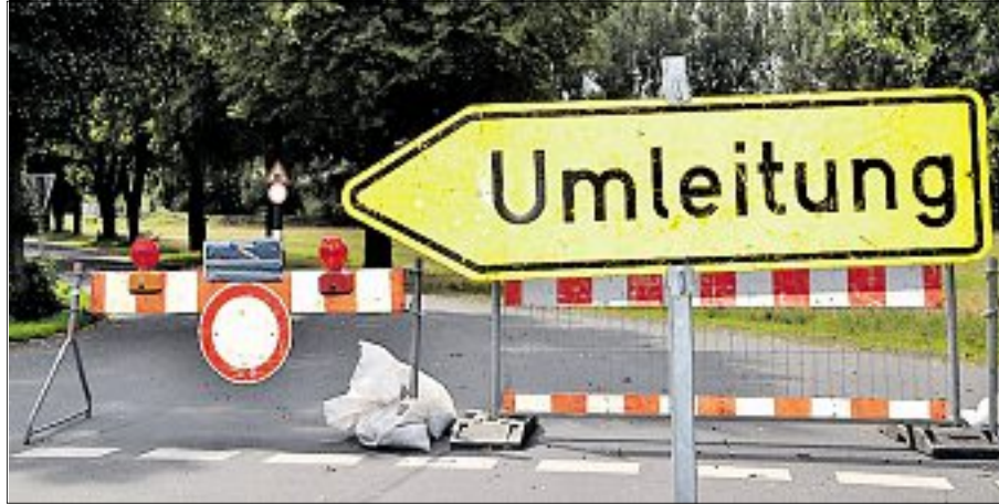
Die Nettebrücke bei Derneburg ist noch immer gesperrt. Autofahrer müssen weiterhin die Umleitung über die Schlossstraße nutzen. Foto: Marwede
